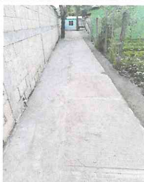
Losa de patio en la entrada principal
